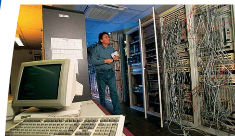
Faciliter le raccordement des équipements en rack.
